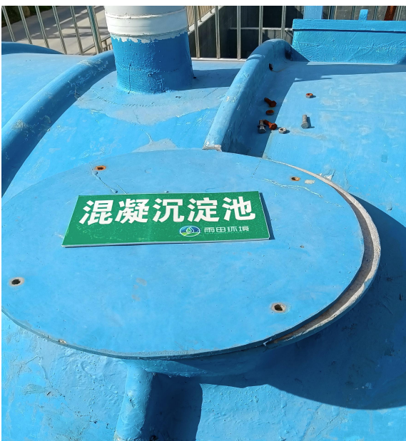
污水处理站（混凝沉淀池）
