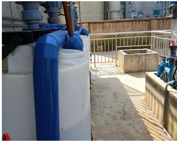
污水处理站（调节池）
