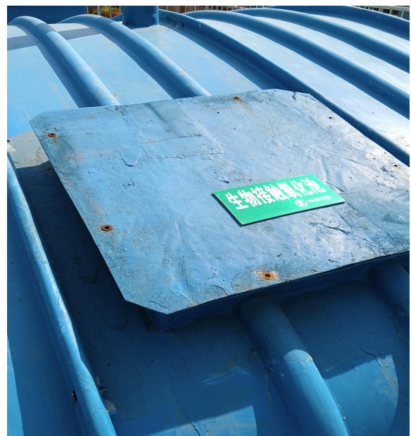
污水处理站（生物接触氧化池）
