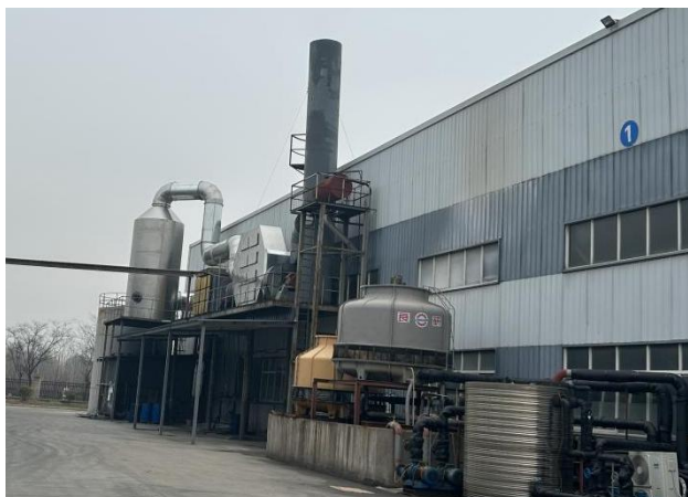
图 4.1-5 G1-2 车间一 PVC 压延膜生产线挤出、开练、过滤、精炼和压延工段 废气设施现状(非甲烷总烃、油雾和和氯化氢) DA002
