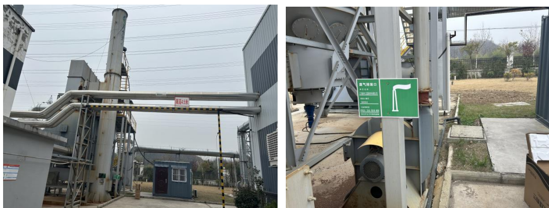
图 4.1-7 G2-1 车间二装饰膜生产线彩印工段、G3-1 车间三自粘装饰膜生产线 复合工段、G4-3 车间三离型材料生产线配料搅拌、上硅、烘干工段和 G4-2 车间 四离型材料生产线印刷工段 RTO 焚烧炉（非甲烷总烃）DA004
