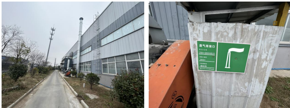
图 4.1-4 G1-1 车间一/PVC 压延膜生产线高速捏合工段废气设施现状 (颗粒物) DA001
