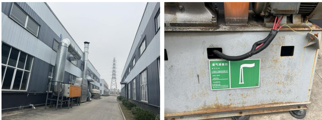
图 4.1-9 G4-1 车间四离型材料生产线淋膜和熔融工段废气设施现状 (非甲烷总烃) DA006
