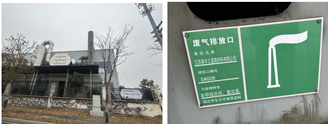
图 4.1-10 车间一 PVC 压延膜生产线逸散废气设施现状 (非甲烷总烃和氯化氢) DA008
