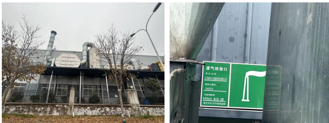
图 4.1-6 G1-2 车间一 PVC 压延膜生产线挤出、开练、过滤、精炼和压延工段 废气设施现状(非甲烷总烃、油雾和和氯化氢) DA003
