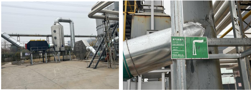
图 4.1-8 G2-2 车间二装饰膜生产线贴合工段废气设施现状 (非甲烷总烃、氯化氢和油雾) DA005
